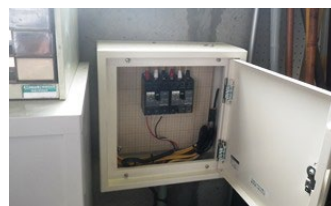
壁の配電盤の電源(200V)
