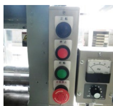
作業者右手側の操作ボタン
