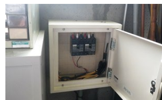
壁の配電盤の電源(200V)
