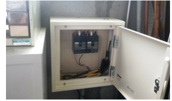
壁の配電盤の電源(200V)
