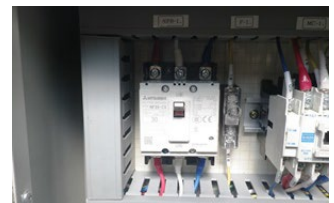
本体電源のブレーカー
