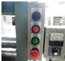
作業者右手側の操作ボタン
